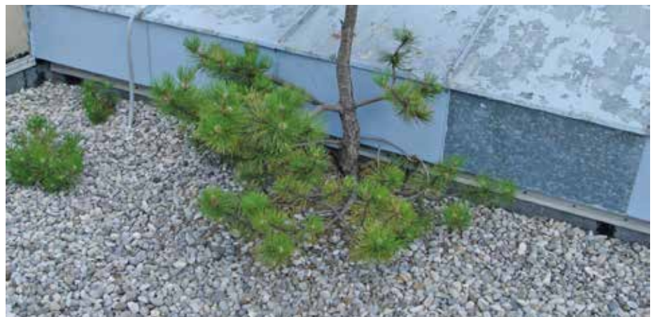
Die Abbildung zeigt deutlich, dass auf gegenständlicher Kiesdachfläche bereits seit Jahren keine Wartung erfolgte. Das Nadelgehölz hatte bereits sehr starke Wurzeln innerhalb des Dachschichtenaufbaus gebildet.
