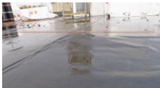
← Gravierende Unebenheiten unterhalb der Dampfsperre.
